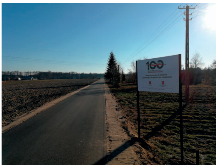
Modernizacja drogi dojazdowej do gruntów rolnych w Zarzeczcu na odcinku 583 m. Wartość inwestycji: 289 875,58 zł.
