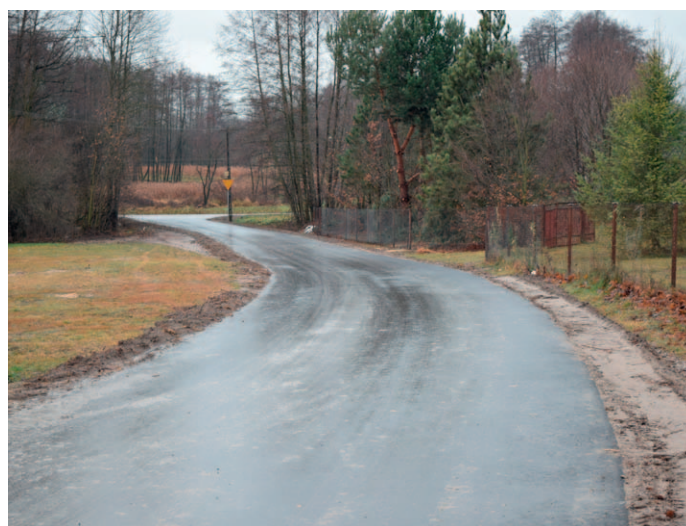
Przebudowa drogi gminnej w Dobrosławowie na odcinku 185,9 m. Łączna wartość inwestycji (Piskorów, Gołąb, Dobrosławów): 527 084,85 zł.
