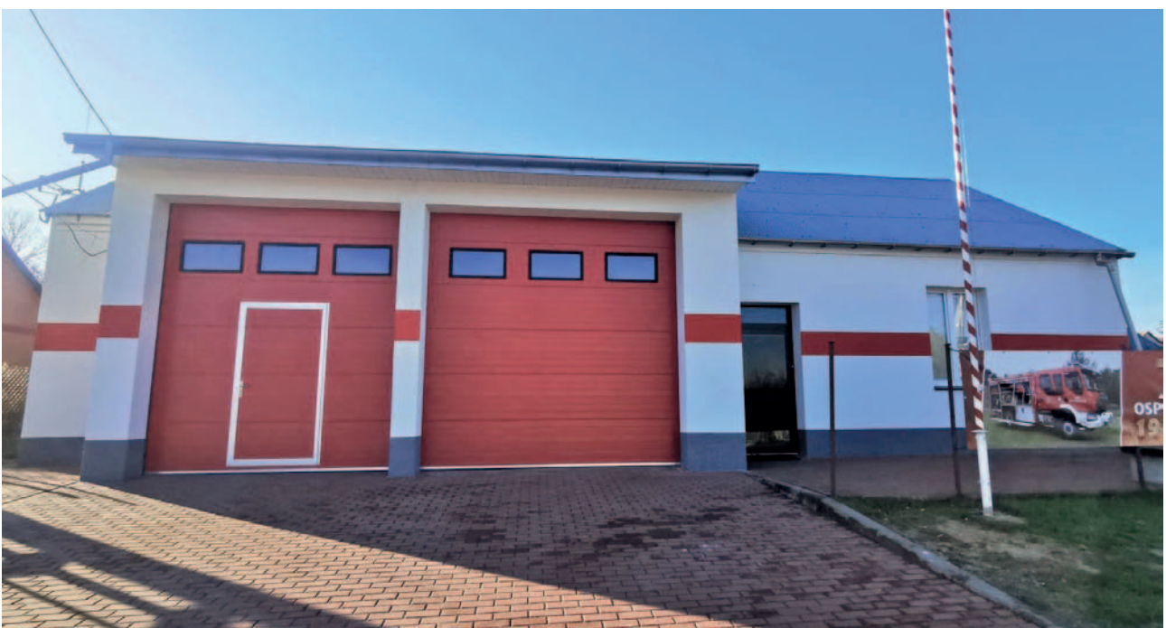
Wykonanie tynku na budynku OSP i świetlicy wiejskiej w Opatkowicach, koszt: 10 000,00 zł
